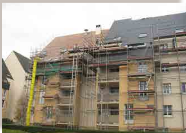
Réfection des toitures en ardoises naturelles Maître d'ouvrage : COPROPRIÉTÉ LES COLIBRIS, LE HAVRE (76)
